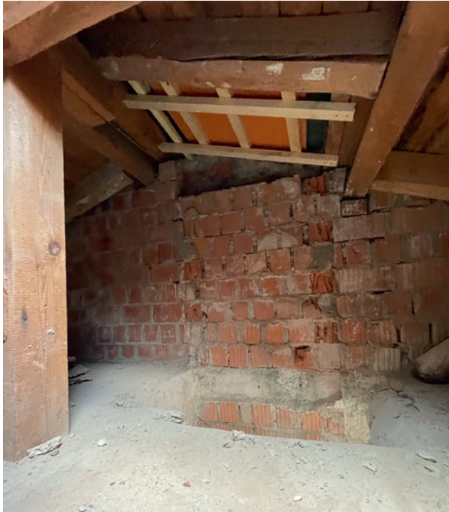
Abb. 6 Der Rückbau eines Kamins schafft Platz und erfordert das Verschließen der Betondecke sowie des Daches; da die Ziegel nicht mehr produziert werden, wurde Ersatz über ein Versteigerungsportal besorgt.
