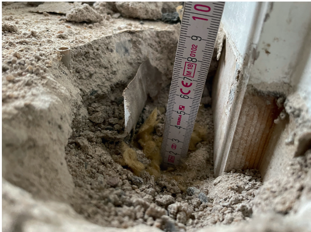
Abb. 2 Zustandsfeststellungen Bodenaufbau. Zur Bestimmung der Mächtigkeiten und für Materialentnahmen zur Beprobung auf Schadstoffe wurde der Fußboden an mehreren Stellen geöffnet.
