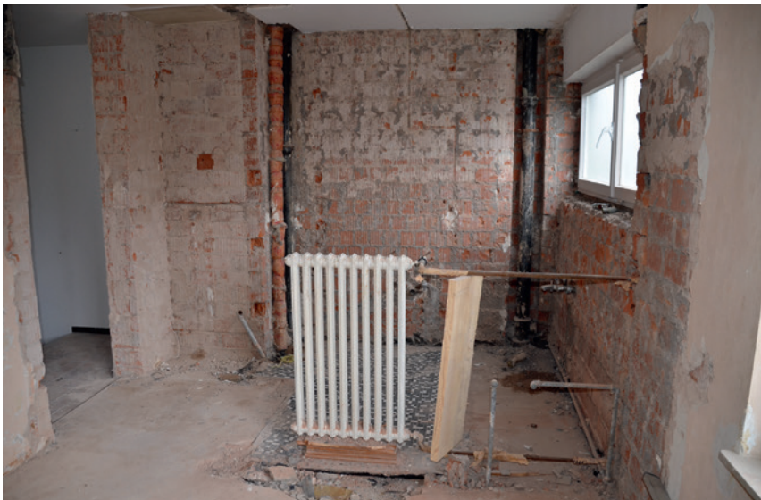
Abb. 7 Durch den Wegfall sämtlicher Heizkörper wird zusätzlicher Wohnraum geschaffen.
