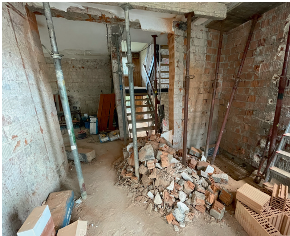
Abb. 4 Die Eingriffe in die Substanz, wie z. B. das Versetzen von Wänden und Türen sowie der Einbau von Stahlträgern zur Wohnraumöffnung, erfordern eine sorgfältige Bestandsaufnahme sowie Bewertungen durch einen Statiker.
