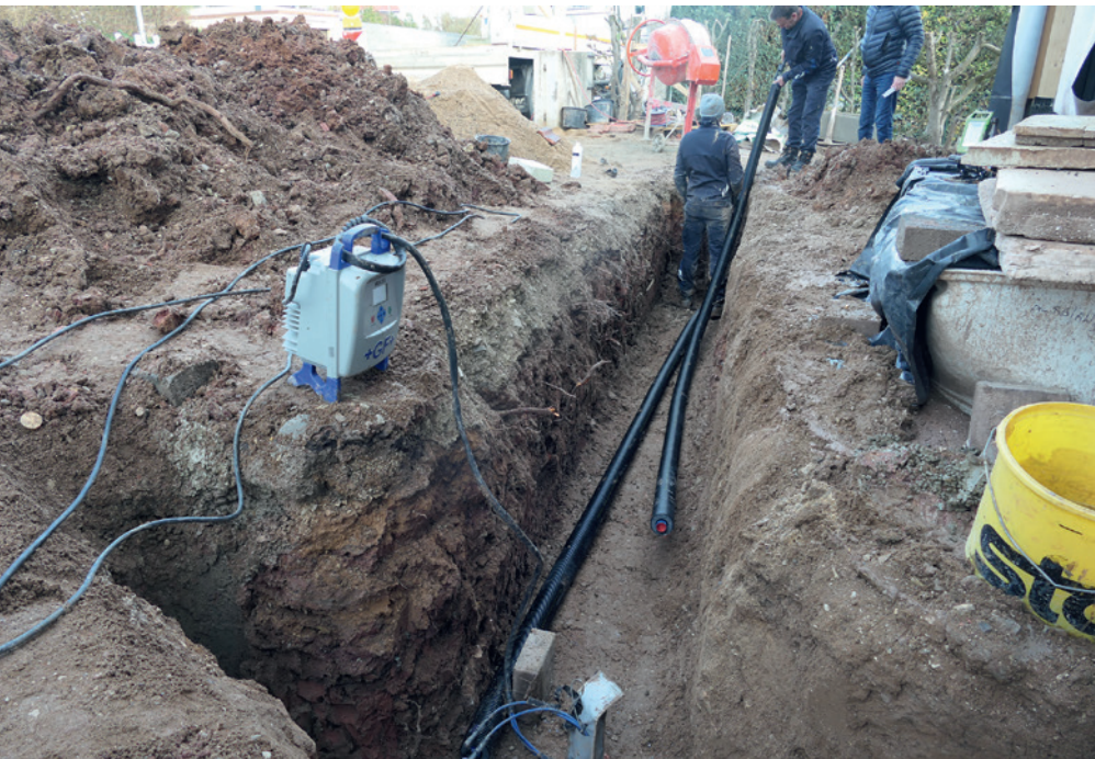
Abb. 5 Die Horizontalanbindung erfolgte ohne Zwischenschicht direkt ins Gebäude, die Zuleitungen wurden gedämmt.
